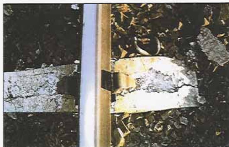
Sviller produsert i Moss i 1978. Det ses riss/sprekker og avskallet betong. Svillen er sterkt skadet og det er risiko for at skinnefestet er løst. Frysetingprosesser har sannsynligvis forverret nedbrytningen av betongen.
