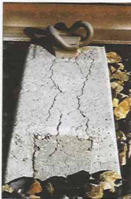
Sville produsert i Verdal i 1973. Det ses flere langsgående riss/sprekker ved svillendeenden.
