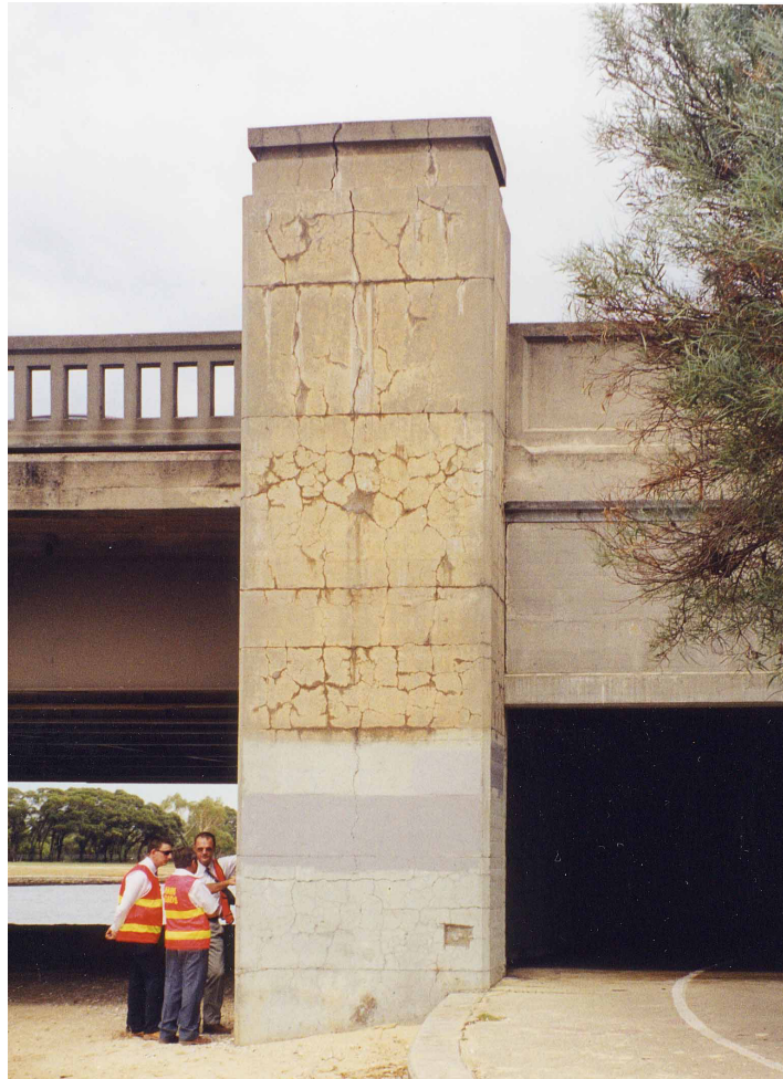
Foto 1: Causeway Bridge i Perth, Vest Australia bygget 1953. Alkalireaksjoner har medført at betongen er revnet og stedvis delt opp i blokke. Størst revnedannelse ses øverst i piler hvor revner opp til ca 2 cm kan observeres. Alkalireaksjoner er forårsaket av bergarten granit som også er eneste bergartstype som anvendes i Perth. I Australia anvendes ikke petrografiske analyser til rutineundersøkelser av betongtilslag. Årsaken til hvorfor granit reagerer i betong er ikke kjent. Fotoet er fra en befaring i forbindelse med forfatterens postdoktorprosjekt, mars 1999.
