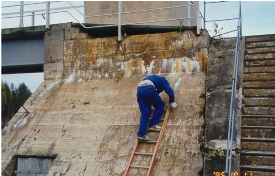
Betongdam bygd rundt 1950 hvor skadelig alkalireaksjon er forårsaket av 2 typer bergarter som ikke står på negativlisten. Rissutvidelse er målt til 0,25 mm per år.
