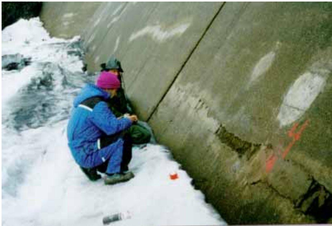
Foto 2 Reparasjon utført for hånd og skadet.
